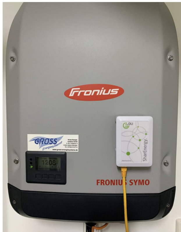
Abbildung 22: OLI Box in Verbindung mit einem PV-Wechselrichter (Quelle: Eigene Darstellung OLI Systems GmbH)
